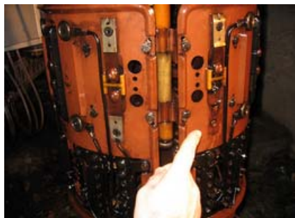
SLIKA 4 - Prikaz prakidačkog dela TRN sa mestom pregorevanja provodnika
